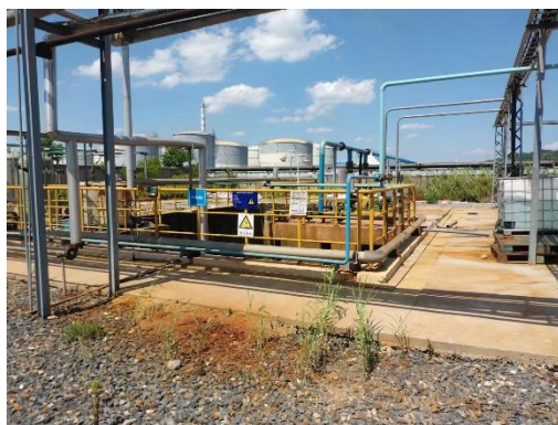
南厂区硫酸中和污水池
